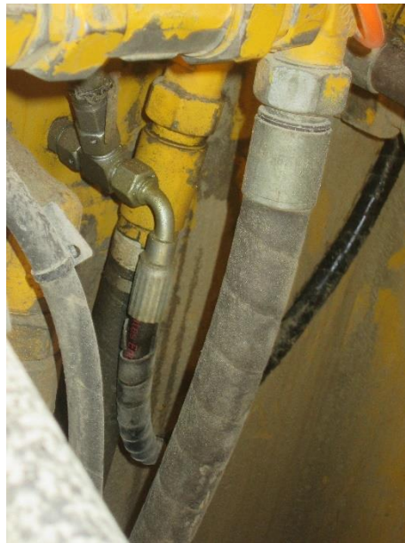
Punto de conexión M14 en estanque de retorno
