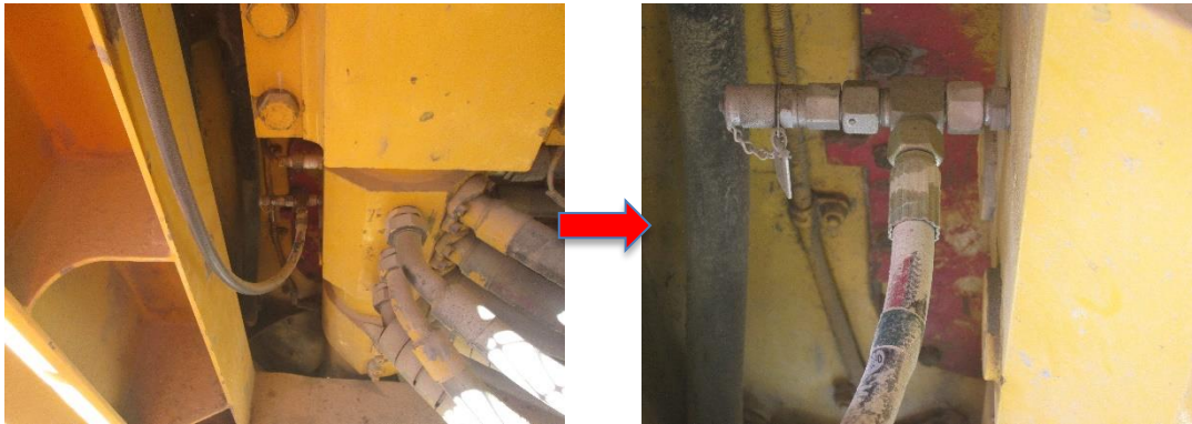
Punto de conexión M15 en tubo colector de retorno
